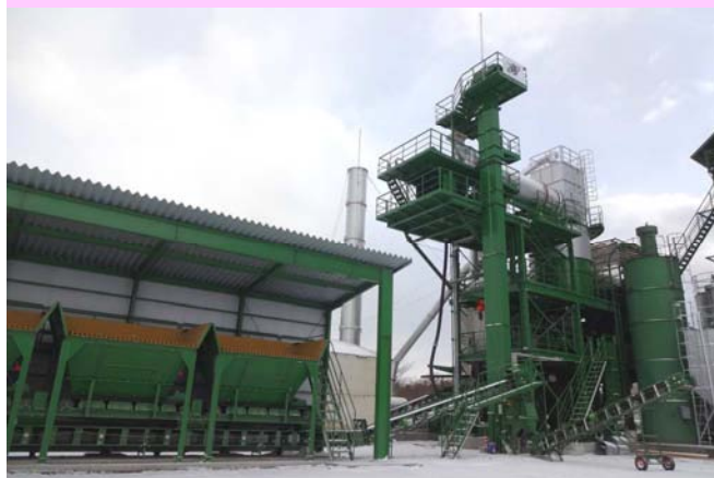
このたび完成した、再生合材プラント設備。
